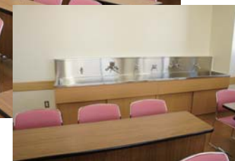
第6会議室付属 水道設備
